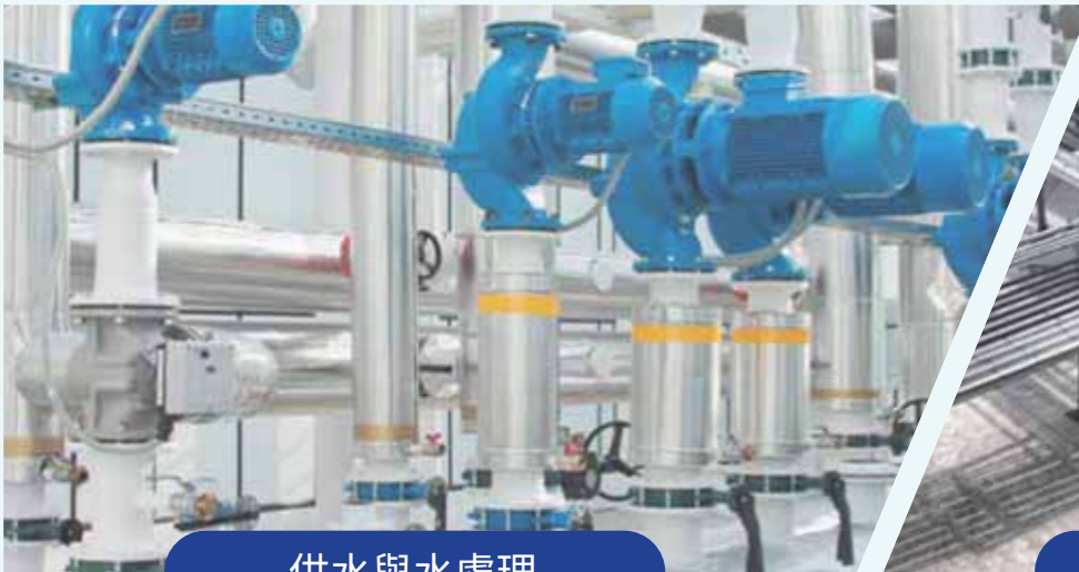
供水與水處理
